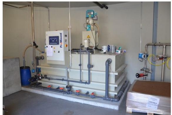
Flockhilfsmittelstation für Schlammvoreindickung.
